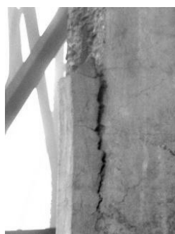
Figura 5.3 - Spalling em pilar de concreto
